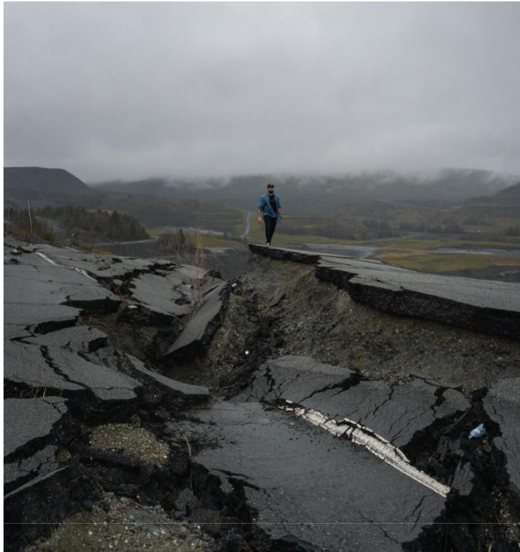
Figura 9: Imagem que representa a destruição de uma estrada depois da passagem de um terremoto. Disponível em: https://unsplash.com/photos/jvibDI60IE .
